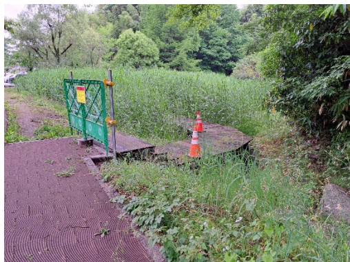
▲一部老朽化のため立ち入り禁止の栈橋
